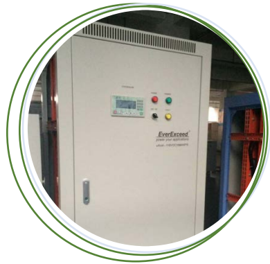
Индонезия, подстанция PLN ЗУ uXcel 110B 100A
