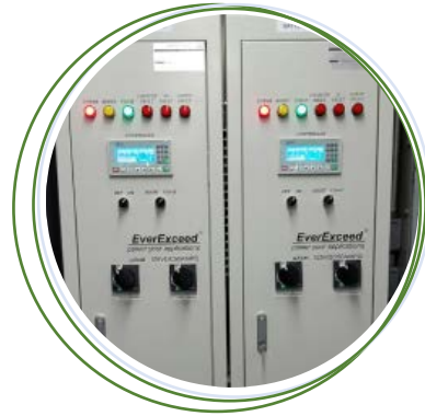
Таиланд, подстанция EGAT ЗУ uXcel 125В 50А
