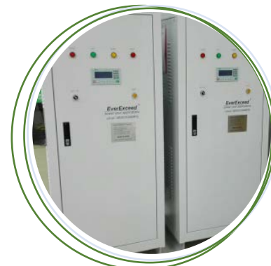
Африка, Мали, подстанция ЗУ uXcel 48В 100А ЗУ uXcel 125В 200А
