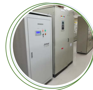
Филиппины, подстанция NGCP ЗУ uXcel 125B 60A
